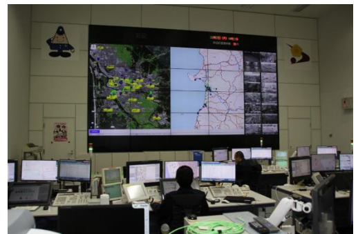
通信指令システム
